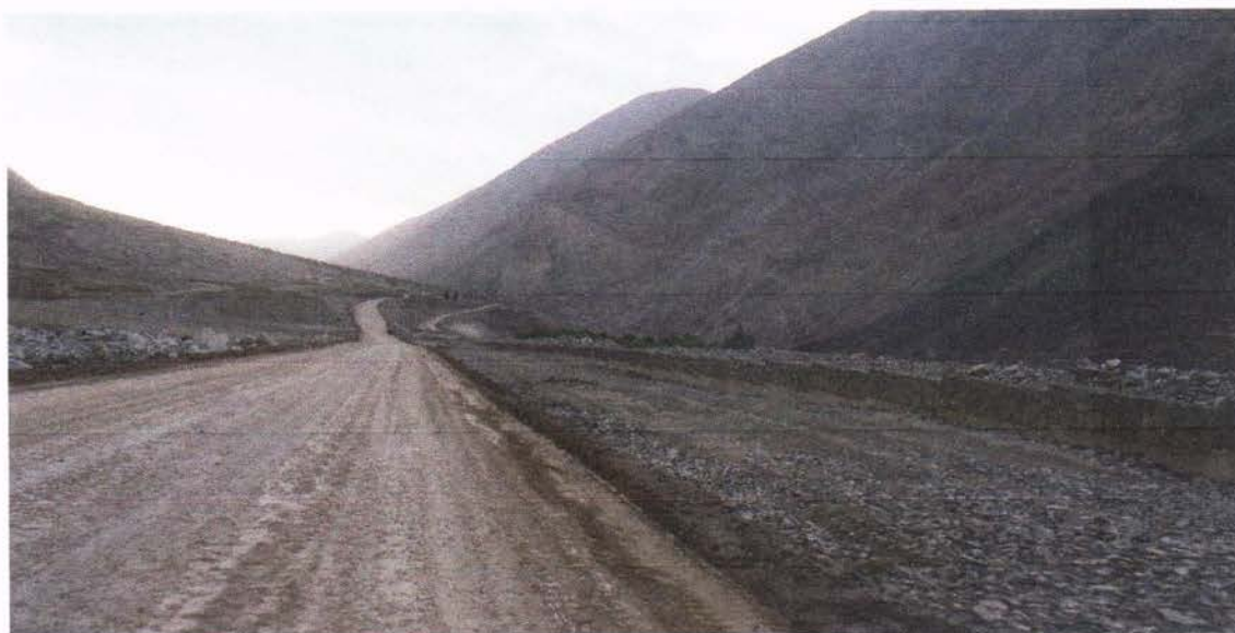
MURO DE CONTENCIÓN DE CONCRETO ARMADO ENCIMADO CON GAVIONES EN LA MARGEN IZQUIERDADE LA QUEBRADA ACAVILLE
